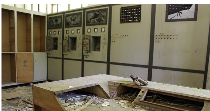
Die Schaltzentrale der einstigen Betriebsfeuerwehr.
