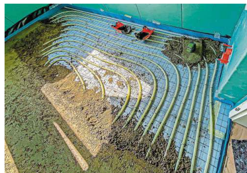
Folgearbeiten einberechnen: Wer eine Wärmepumpe einbauen lässt, benötigt wegen der niedrigeren Vorlauftemperatur unter Umständen größere Heizkörper, idealerweise eine Flächenheizung. FOTO: ALEXANDER LUDWIG/DPA
