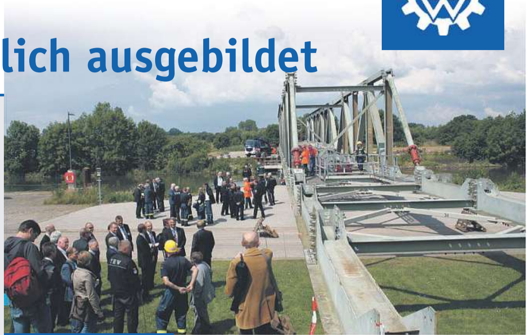
Brückenbau über die Weser in Barme mit vielen Gästen aus Politik, Wirtschaft und Verwaltung.
