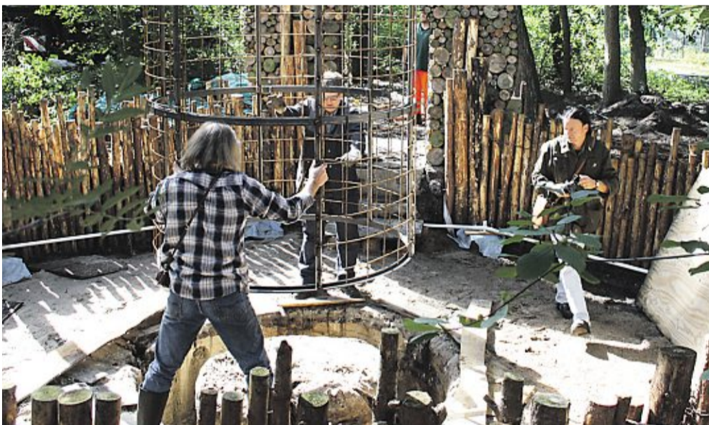
Bert Strebe, Jürgen Stegmann und Pablo Hirndorf sind am Ziel: Das Mittelstück der Fertigzeltkonstruktion ist eingesetzt.
