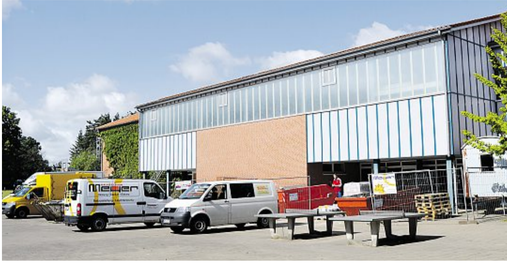
Ach die Heemser Turnhalle, die zurzeit aufwändig saniert wird, wird seit kurzem mit der Biogas-Wärme von Gut Wiede beheizt. Foto: Hagebölling
