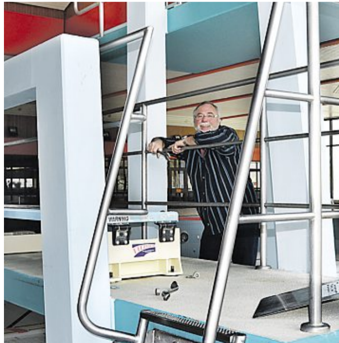
Der Geschäftsführer der Firma Bock aus Kiel demontiert die beiden Sprungtürme. Mittlerweile stehen auch gebrauchte Ausstattungsgegenstände für Hallen- oder Freibäder hoch im Kurs.
